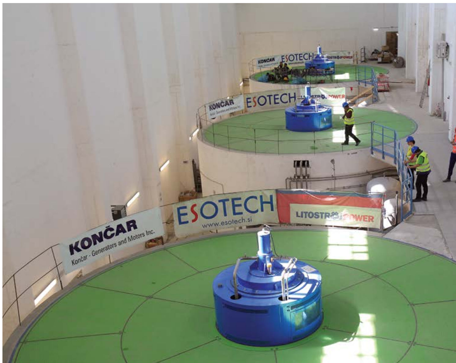
Agregata 1 in 2 sta v obratovanju, agregat 3 pa je bil maja prvič sinhroniziran z elektroenergetskim omrežjem.
