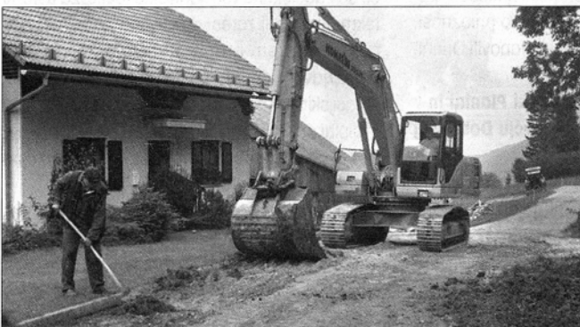
Celotno traso »senčne ceste« bo možno rekonstruirati po sanaciji plazu (foto: JP)
