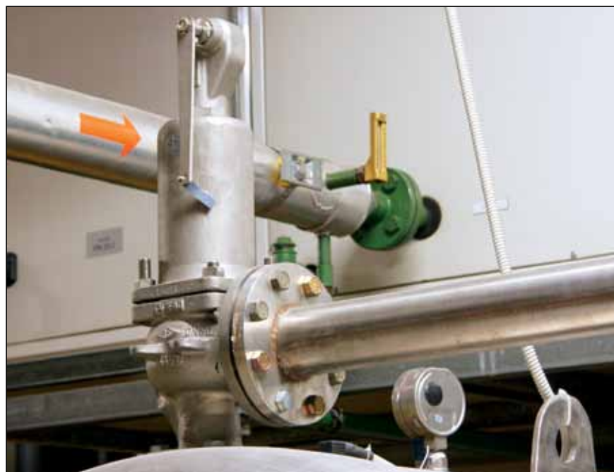
Slika 1. Oprema pod tlakom in varnostni ventili spadajo v zakonsko opredeljeno opremo in jih je potrebno v skladu z zakonodajo redno preverjati. Tovrstne preglede lahko opravljajo samo pooblaščen osebe (OPP – organ za periodične preglede) Ministrstva za gospodarstvo.
