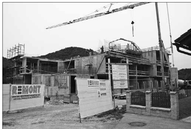
Delavci zaključujejo s prvo fazo gradnje varstveno delovnega centra na Mozirskih tratih. (Foto: Benjamin Kanjir)
