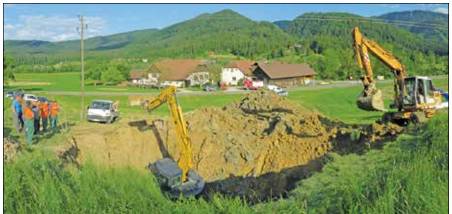
V petek je glavni vod počil še v Kokarjah, in to na globini okoli osmih metrov. Sanacija je potekala nepretrgoma do ureditve razmer. (Foto: Igor Solar)
