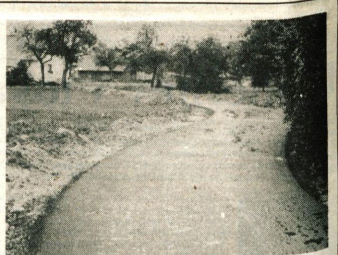
Novi kilometri asfalta — Krajevna skupnost Velesovo skoraj vsako leto uredi nekaj cest. Tako je bilo tudi letos. Pretekli teden so vgradili asfalt na nekaterih cestah v Velesovem, na Trati in Praprotni polici v skupni dolžini 3400 metrov. Ljudje teh vasi so se tudi takrat izkazali, saj so sami opravili pripravljiva dela, vredna nad 2 milijona dinarjev. Na Praprotni polici so še sami kupili 400 kubikov gromaža, sami poskrbeli za prevoz in ga vgradili. (J. K.) — Foto: F. Perdan
