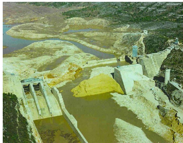
Slika: Pregrada Tous po porušitvi.
