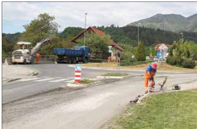
Razpokan in naguban asfalt so delavci VOC Celje zamenjali z novim. (Foto: Benjamin Kanjir)
