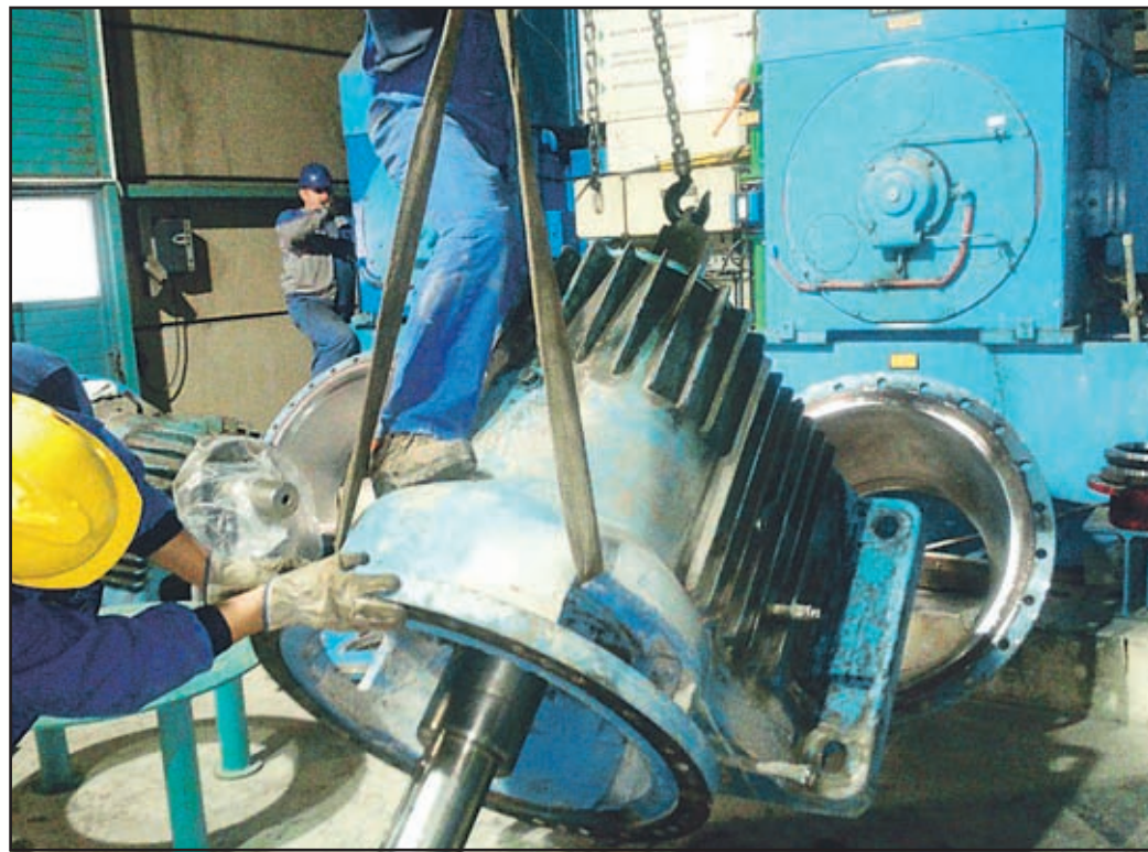
Revizija obtočnih črpalk čistilne naprave
