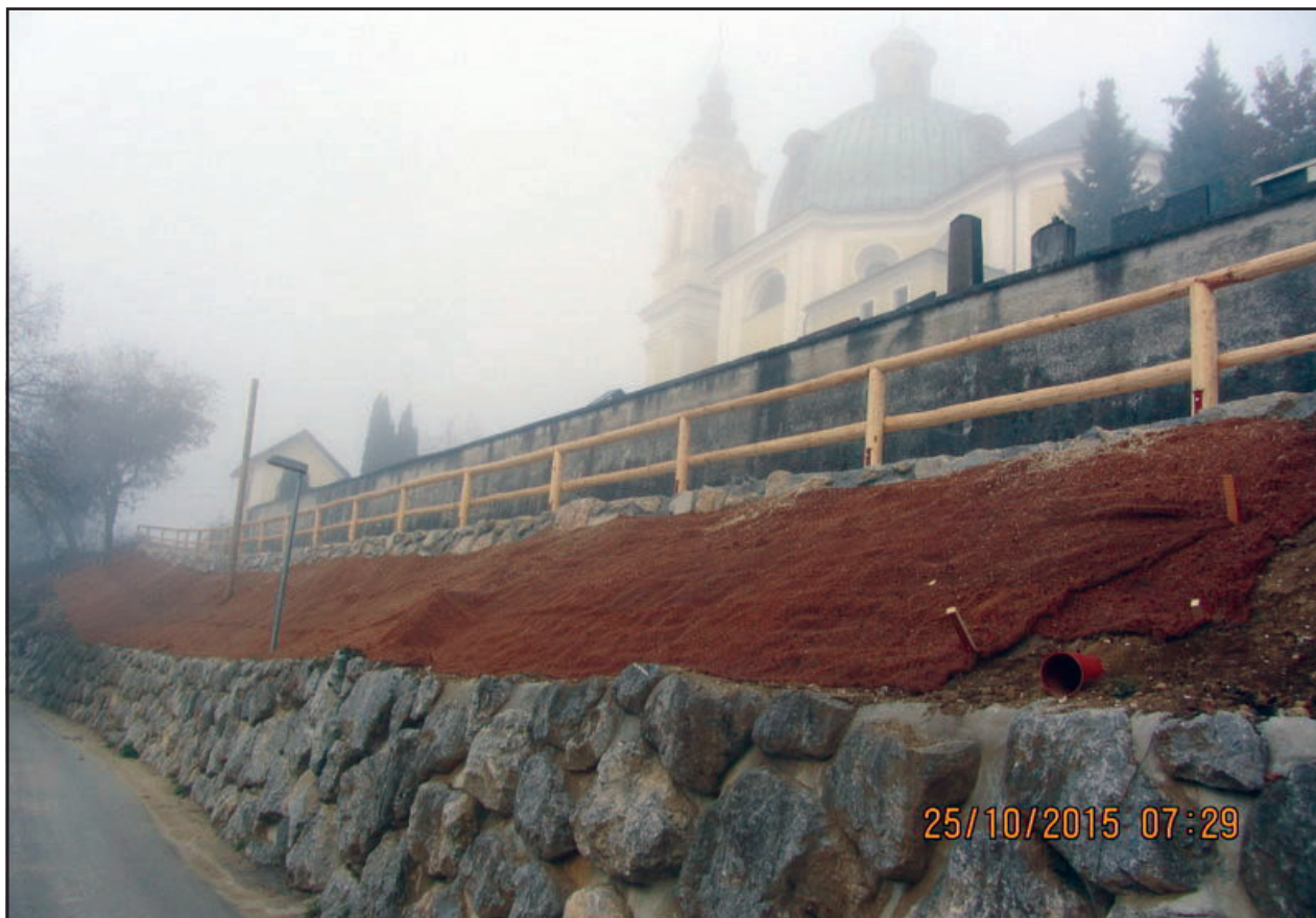
Sanacija zemeljskega plazu pod pokopališkim zidom v Tunjicah (Foto: arhiv Občine Kamnik)
