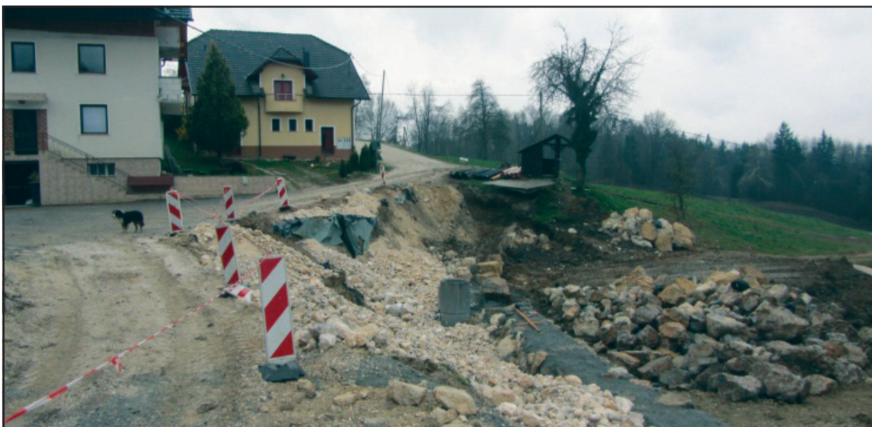
Sanacija plazu pod javno cesto v Tunjicah pri hiši št. 40 (Foto: arhiv Občine Kamnik)
