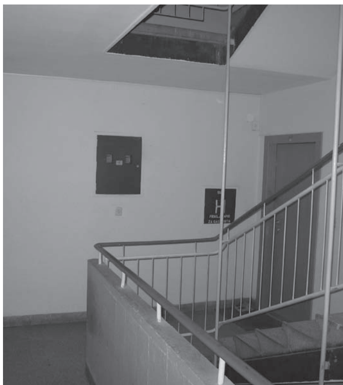
Slika 5: Odprto stopnišče z lesenimi vhodnimi vrati ne ustreza današnjim zahtevam protipožarne varnosti stanovanjskih stolpnic.
