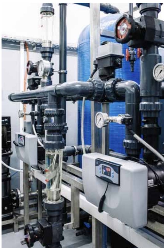
Slika 6: Izvedena filtrirna naprava v objektu za pripravo in prečrpavanje pitne vode v Jami Vir: Interno gradivo podjetja Kostak, d. d.
