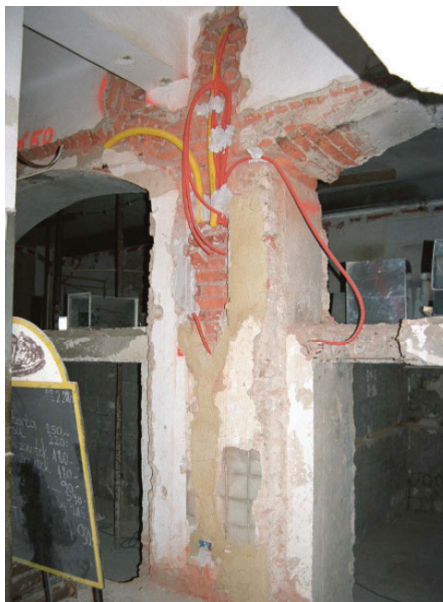
Slika 19 • Primer nevarne oslabitve konstrukcije.
