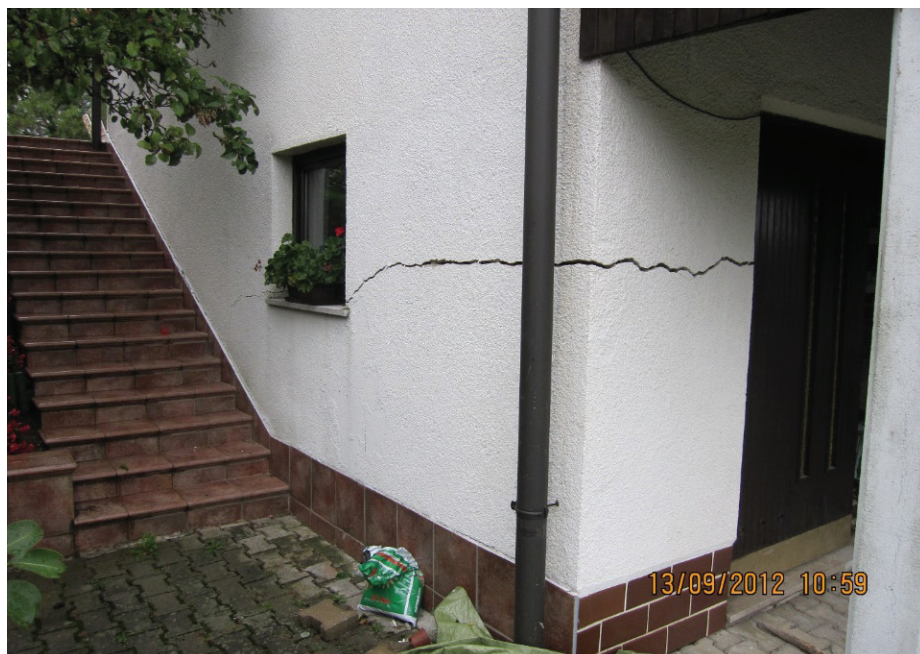
Slika 9 • Odpoved konstrukcije zaradi premikov tal.
