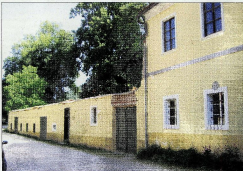
Od velikih razvojnih projektov ni ostalo nič. Da so za Dvorec Trebnik v zadnjih letih slaba skrbeli, se vidi na vsakem koraku. Na posnetku del dvorca, ki ga je za pred časom prizadel požar.
