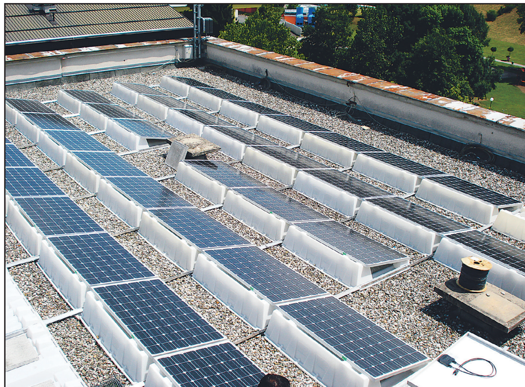
Streha občinske hiše je dobila novo funkcijo – na njej stoji prva sončna elektrarna v mestu, ki pa sonca še ne more izkoriščati, ker še ne deluje.
