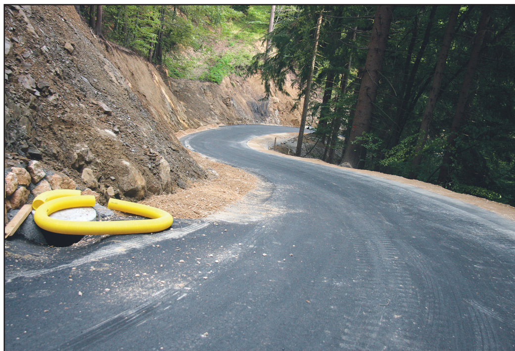
Gradbena dela na cestah bodo zagotovo povzročala tudi občasne zastoje. A že jeseni bodo vožnje po njih varnejše in lepše. Tudi na cesti proti Graški gori.
