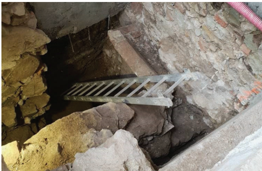
Slika 11 • Izkop globljih vertikalnih karnadov, vidni so ostanki stropnega oboka srednjeveške kleti ter lokalno izžagano kamnito-opečno gradivo.
