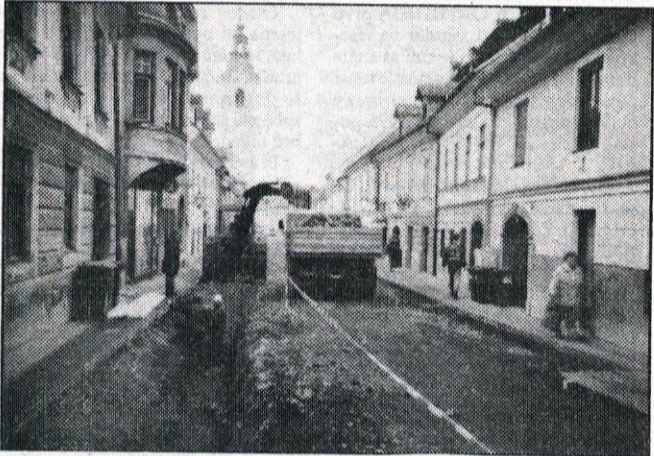
Ureditev šutne in odprtje prometa burita kamniške duhove. Delavci Komunalnega podjetja Kamnik, ki so po veliki noči začeli prekopavati obnove nujno potrebno ulico, pa pridno delajo naprej.
