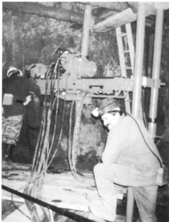
SLIKA 4: PRIPRAVA HIDRAVLICNEGA VRTALNEGA STROJA RVS-04 ZA VRNANJE V KOMORI NA VII. OBZORJU (FOTO: B. REŽUN, 1996).
