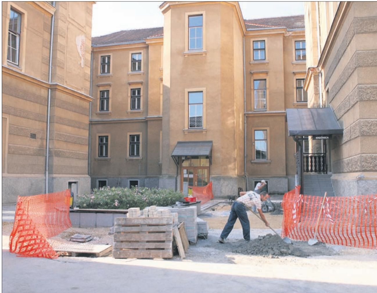
Del dvorišča III. Osnovne šole Celje bo poslej prekrit s tlakovci, del bo še vedno ostal v asfaltni izvedbi. Parkiranje ne bo več dovoljeno, vseeno pa bo na šolsko dvorišče mogoč uvoz avtomobilov.
