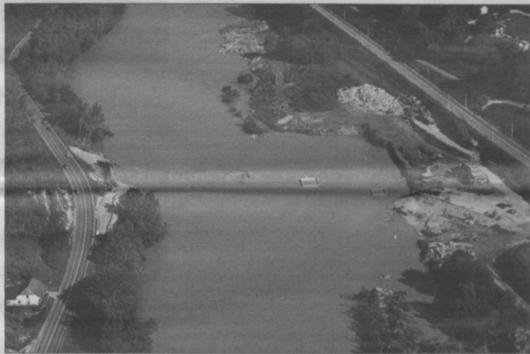
Poplavljeni gradbišče novega mostu čez Savo pri HE Krško (Foto: Ljubo Motore)
