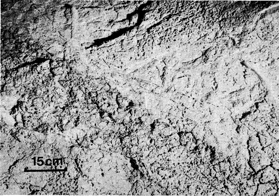
Sl. 2. Odsek drobno razjedene stene: luknjičasto površje Fig. 2. A part of thinly corroded wall: sponge work
