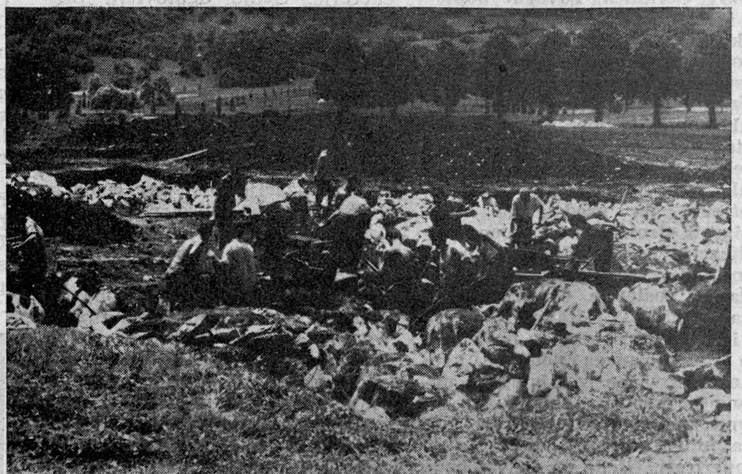
Dolgoletna želja članov kolektiva Kovinoplastike se je naposled le uresničila. V juniju so se začela prva dela na prostoru, ki je predviden za gradnjo nove tovarne
