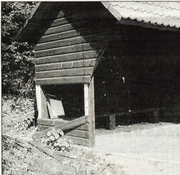
Posledice vandalskega uničevanja bo treba odpraviti.
