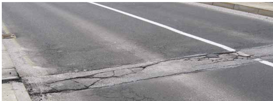
Slika 23 • Poškodba polnila dilatacije.
