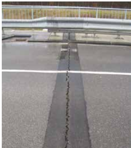
Slika 24 • Sredinska vzdolžna poškodba dilatacije.
