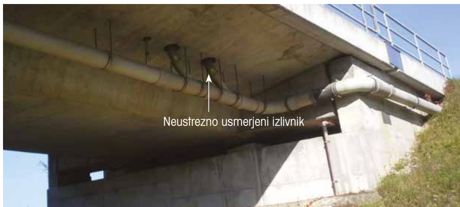
Slika 31 • Neustrezno usmerjeni izlivnik za čiščenje in vzdrževanje cevi za odvod meteorne vode z mostu.
