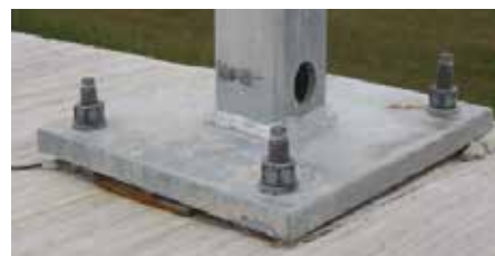
Slika 27 • Neustrezni jekleni podložki in onemogočeno ustrezno podlivanje.
