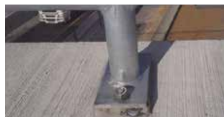
Slika 26 • Neustrezni jekleni podložki in onemogočeno ustrezno podlivanje.
