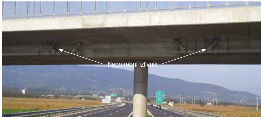
Slika 30 • Nepotrebni izlivnik za čiščenje in vzdrževanje cevi za odvod meteorne vode z objekta.
