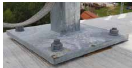
Slika 25 • Neustrezni jekleni podložki in onemogočeno ustrezno podlivanje.
