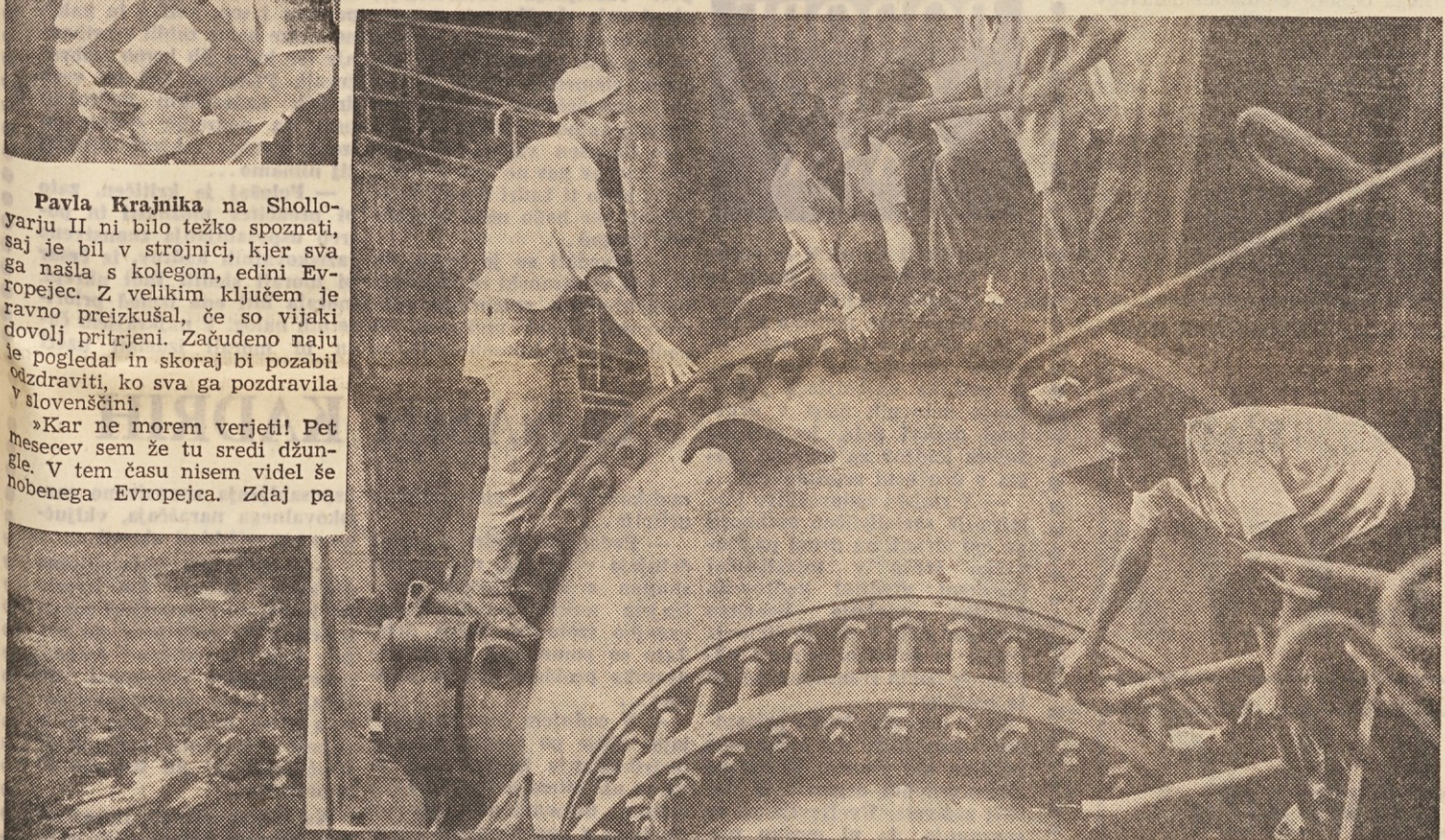
Pavle mora biti vedno prisoten, saj mora preveriti do pičice natančno vse, kar montirajo pri turbini
