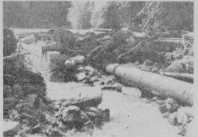
Človek gradi - narava uničuje. Junjsko neurje je dobesedno odneslo odsek ceste na Skomarje, ki so jo ob deležu združenega dela in Cestne skupnosti z veliko vneto in prostovoljnimi prispevki gradili tudi krajanje sami.
