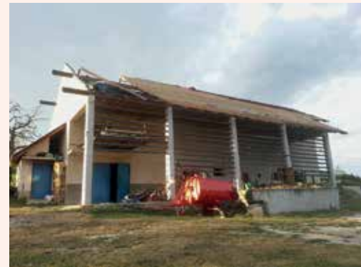
Gorišekovim in Šolinčevim iz Požnice je lani vihar skoraj v celoti razkril in poškodoval skoraj novo gospodarsko poslopje.
