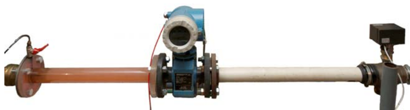
Slika 5.6: Umirjevalni del z induktivnim merilcem pretoka na iztoku preizkuševalne cevi
