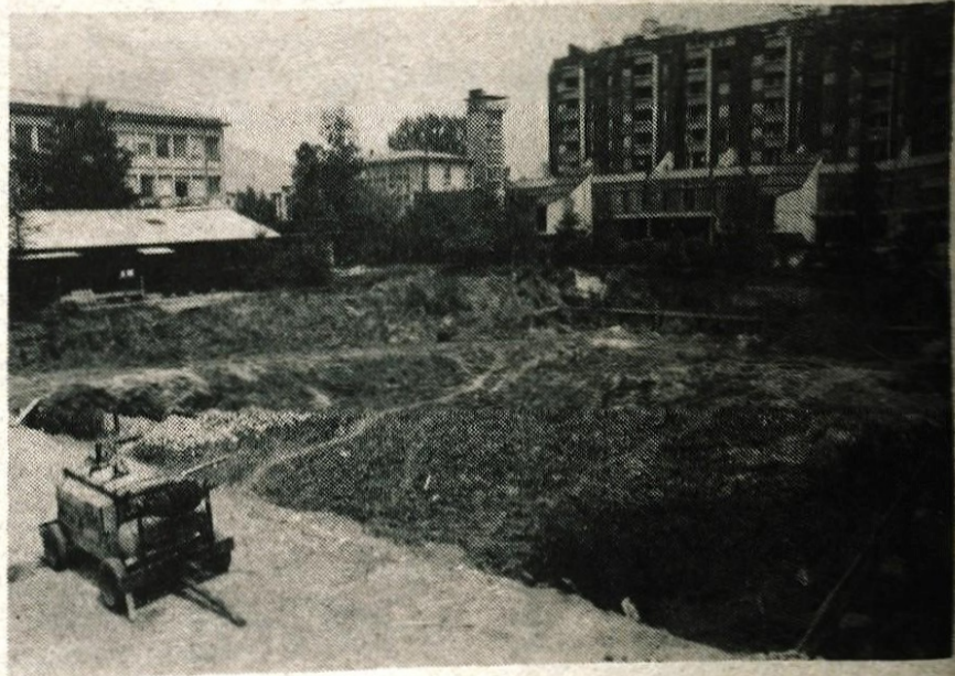
Kranj — Sredi maja so se začela pripravljala dela za dolgo pričakovano gradnjo nove stavbe Zavoda za socialno medicino in higieno za Gorenjsko. — Foto: F. Perdan
