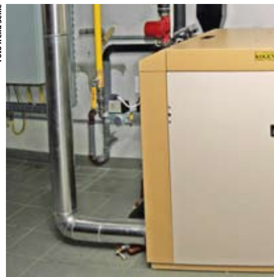
Kogeneracijska naprava v upravni stavbi Elektra Gorenjska.
