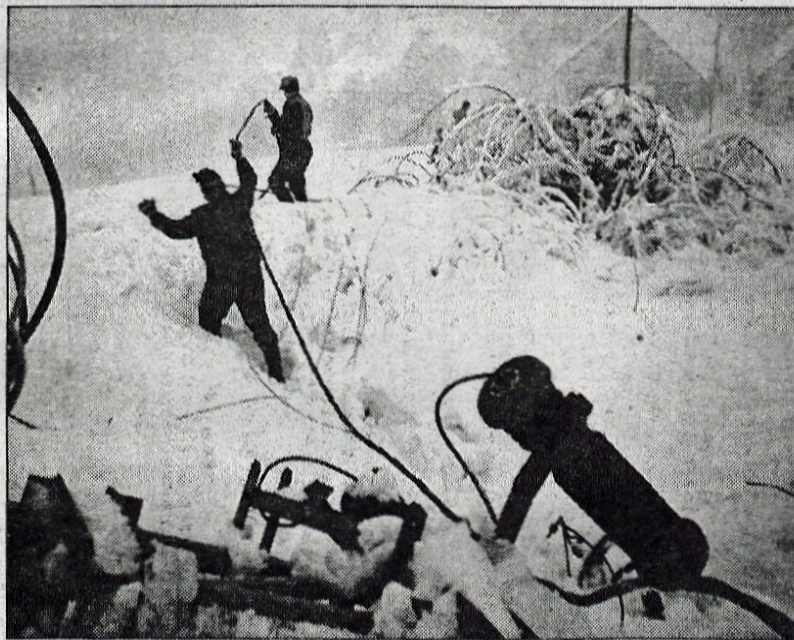
Zaradi pretrganosti vodnikov so delavci Elektra Gorenjske provizorično potegnili snopasti izolirani kabel.
