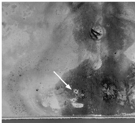
Sl. 2. Korozijske jamice na notranji površini cevi
