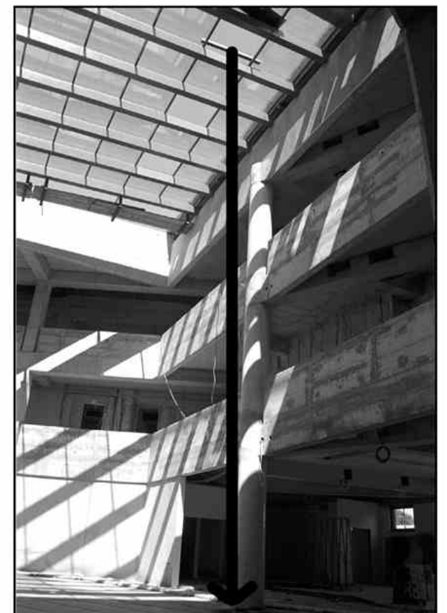
Skozi luknjo na strehi, ki naj bi bila pripravljena za strešno okno, naj bi delavec padel globoko v jamo, na beton. (Foto: vos)
