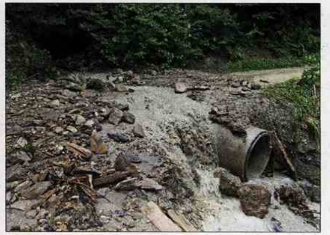
Zaradi ogromne količine padavin voda ni uspela pravočasno odtekat.
