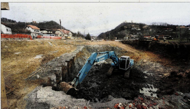
Gradbišče, kjer bo stala nova OŠ Frana Kranjca, zaenkrat ni videti ravno obetavno. Občina vseeno prodvevda zaključok del nekoje do začetka šolskega leta 2007/08.
