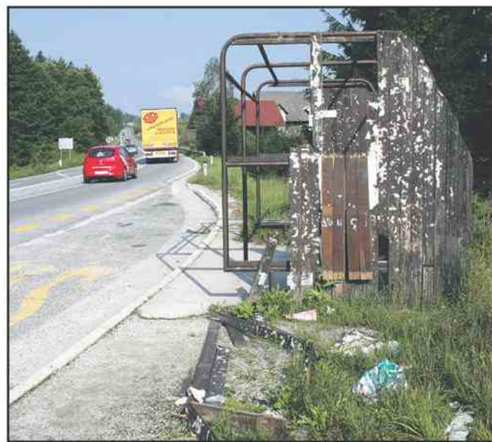
Avtobusna postajališča v Vinski Gori, sploh ob cesti proti Celju, je zob časa že krepko načel ...
