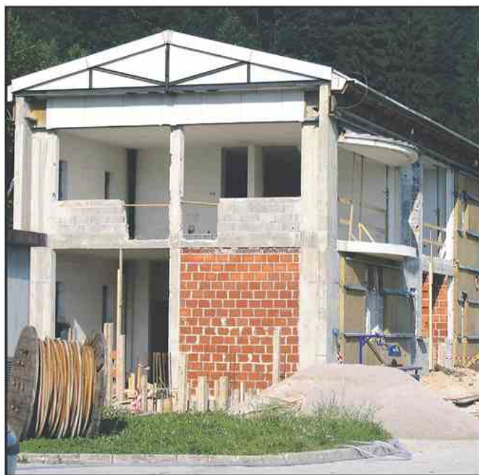
Z obnovo in dozidavo obstoječe upravne stavbe bodo posodobili tudi laboratorij, v katerem bodo opravljali analize odpadnih, pitnih in sistemskih voda v toplovodnem omrežju tudi za zunanje naročnike.
