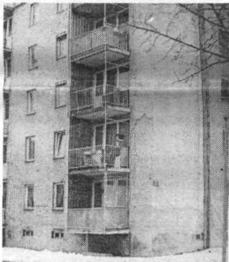
Na Vožarskem potu 10 v KS Prule imajo stolpič, ki razpada. Zgrajen je iz zelo neakovostne opeke, ki očitno ni obstojna. Na stenah so se že pojavile razpoke in tudi omet je močno načet. Stanovalci opozarjajo pristojne organe stanovanjske skupnosti in občine, vendar doslej brez uspeha. Kaže pa, da bo treba ukrepati čimprej, saj ni videti, da bi se proces razpadanja ustavil in utegnilo bi se zgoditi, da bi prišlo celo do nesreče. Foto: B. Barbir
