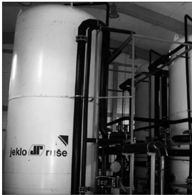
Slika 5: Peščeno-ogljene filtri na obstoječi čistilni napravi zagotavljajo dodatno kakovost in varnost pitne vode.
