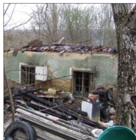
Takoj po požaru
