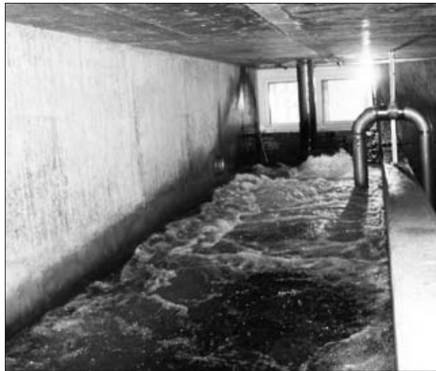
Slika 4: S pomočjo ejetorja se črpna voda prezračuje s kisikom.
