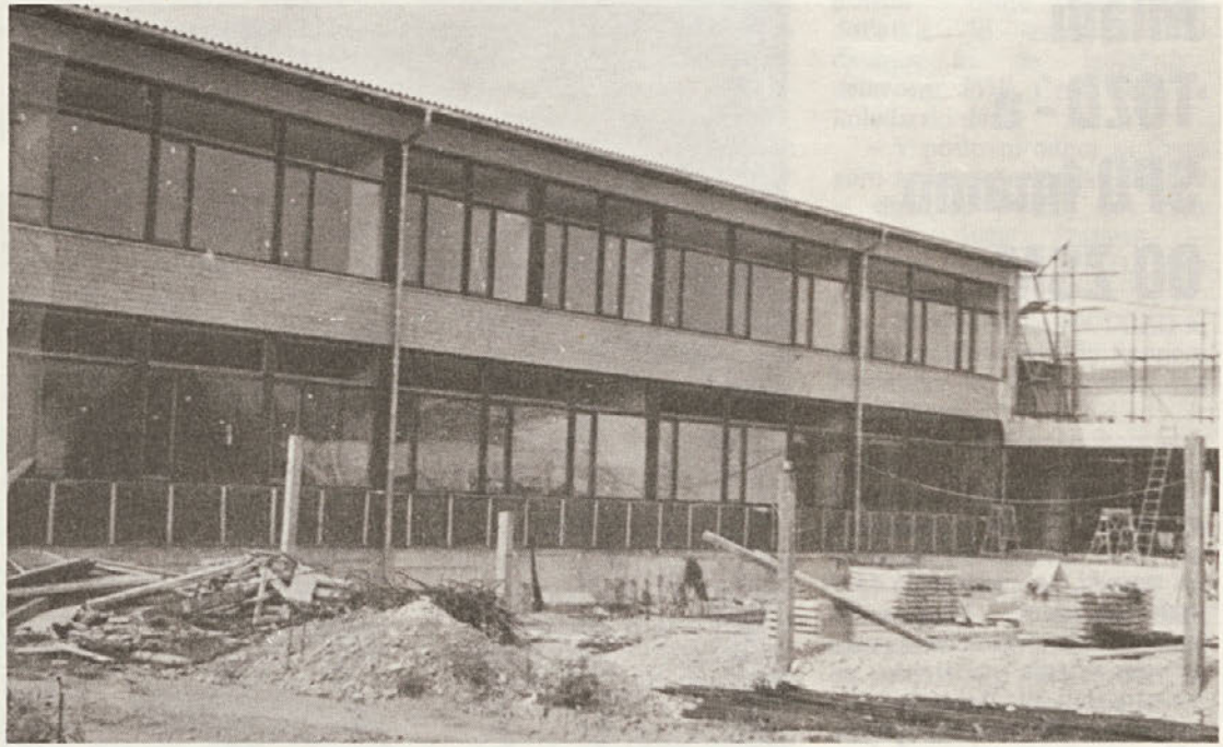
Gradnja šolske stavbe Osnovne šole v soseski BS-3 v Ljubljani; v tem delu stavbe so učilnice
