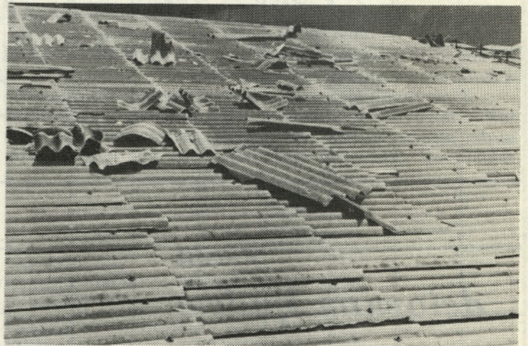
Neurje s točo, ki je v torek, 29. junija zajelo del Kranja in okolico, je zapustilo take posledice na strehi v kotlarni obrata I
