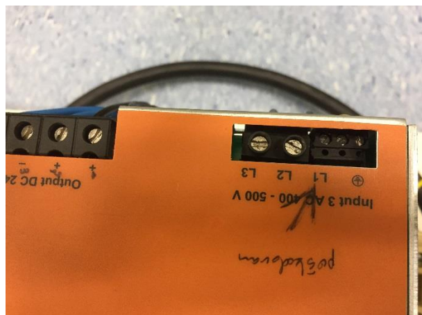
Slika 13: Primer poškodovanega materiala.
