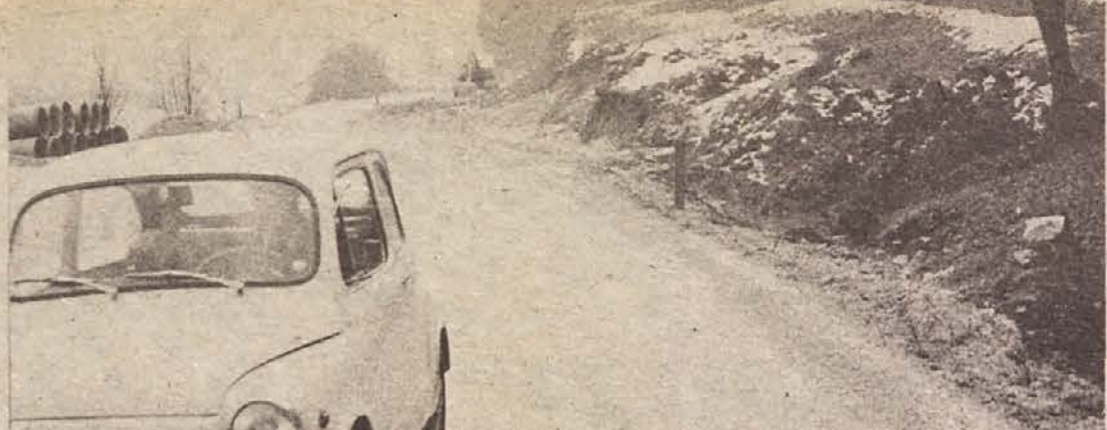
OVINKI ŽE SEKAJO - Gradbena dela pri modernizaciji ceste Srebrnice-Dol. Toplice so v teku in je že tudi kaj videti. Ovinkasta cesta ob Krki nasproti Zaloga bo očitno bolj ravna. Kljub slabemu vremenu se dela nadaljujejo. (Foto: R. Bačer)
