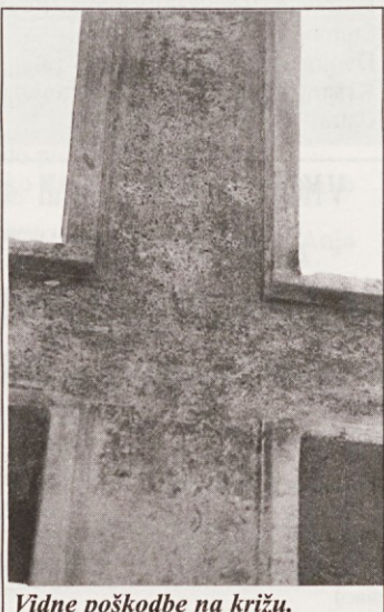
Vidne poškodbe na križu.
