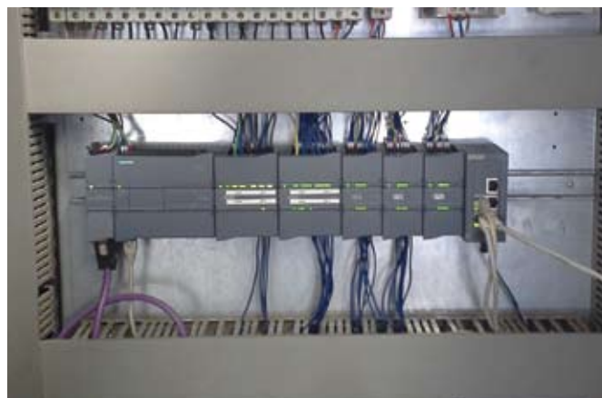
Novo krmiljenje s krmilnikom Siemens Simatic S7 1200
