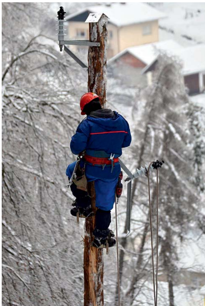
Foto arhiv Elektra Maribor
