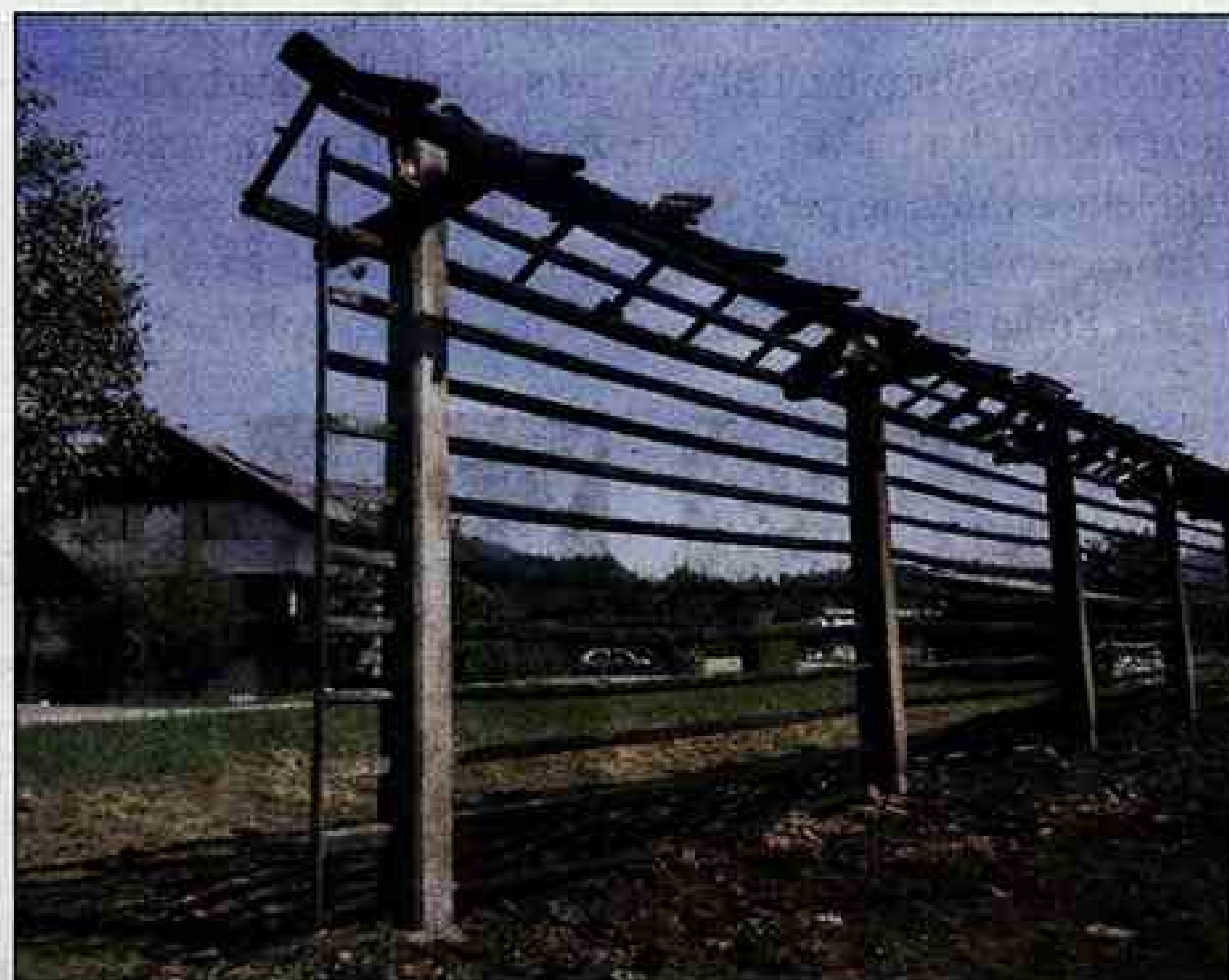
Ogenj se s kozolca v Godiču k sreči ni razširil na bližnje stanovanjske hiše.
