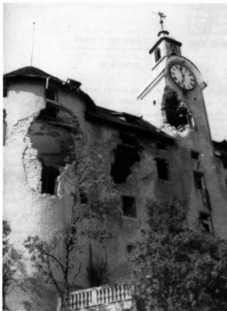
Poškodovano pročelje idrijskega gradu fotografirano po vojni.
