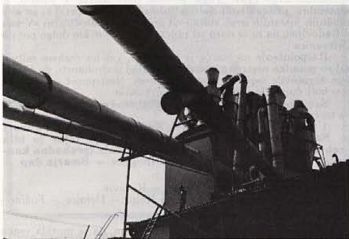
Del odsesovalnih naprav ob rekonstrukciji
