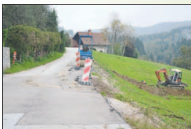
Visoke in nevarne razpoke na cesti so nastale z drsenjem na plavovitem terenu.
