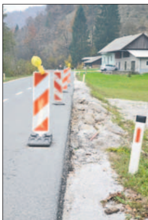
Poškodbe cestišča na regionalni cesti v kraju Log pri Hrastenicah.
